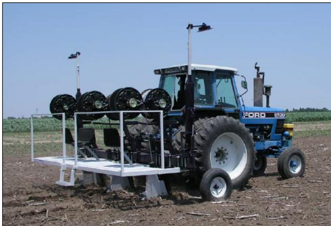
Figura 22. Instalación de laterales de riego por goteo subterráneo por tractor. Fuente: Lamm et al. , 2006.
