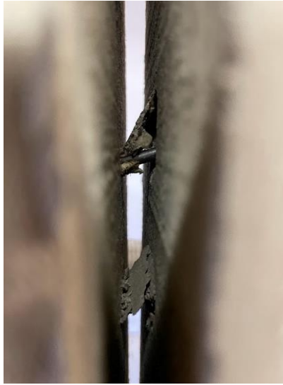
Figura 4.11 Modo de falla de deslizamiento del conector.
