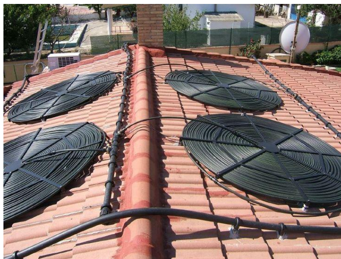
Figura 9: Ejemplo de Colectores solares
