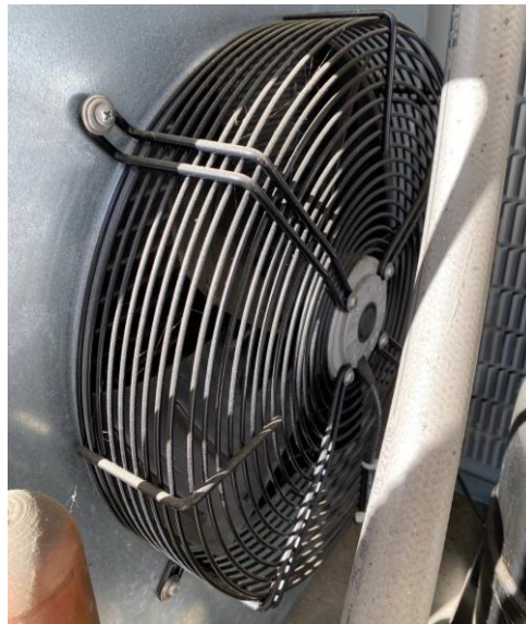
Figura 3.19: Ventilador Ebmpapst del condensador.
