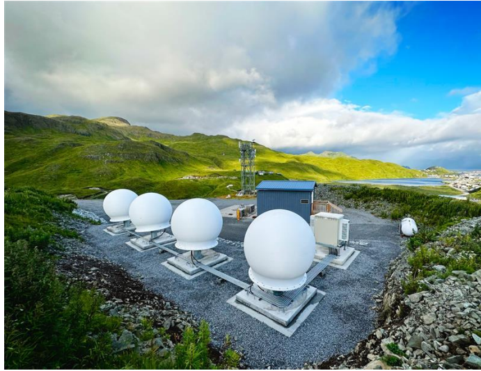
Figura 2-13: Ejemplo de estación terrestre de Starlink (GateWay). Fuente: starlinkinternet.
