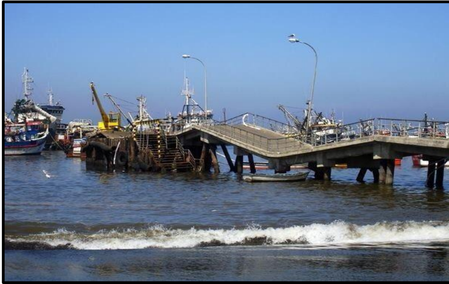
Figura 7. Muelle artesanal Lo Rojas dañado a consecuencia del terremoto del 27F.
