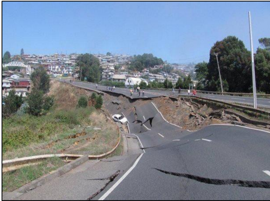
Figura 5. Calles de la comuna en mal estado producto del terremoto de 2010.
