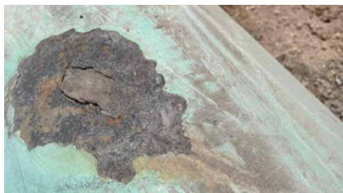
Figura 7.11 Tubería con alto grado de corrosión.
