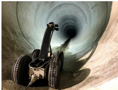
Figura 3.2 Ejemplo de inspección televisiva con robot.
