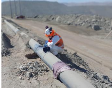
Figura 3.5 Inspección espesores tubería de relave.
