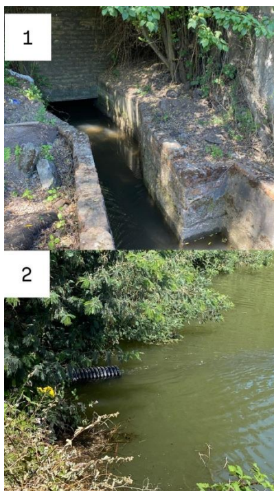
Figura 5. Compuerta de agua procedente del Canal de la Luz, con destino al tranque (imagen 1: compuerta; imagen 2: destino).
