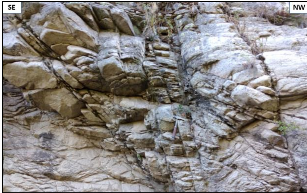
Figura 4.2. Fotografía de afloramiento altamente fracturado en cauce del río. Punto de terreno Geo8.
