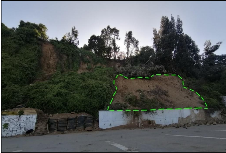
Fotografía 5.3.: Deslizamiento de suelo y rocas marcado con línea segmentada, cerro La Virgen, comuna de Coronel. Fuente: Archivo fotográfico Grupo de Multiamenazas Biobío, 2022
