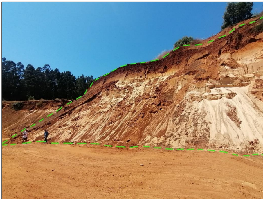
Fotografía 5.1.: Deslizamiento traslacional marcado con línea segmentada, Lomas Coloradas, San Pedro de la Paz. Fuente: Archivo fotográfico Grupo de Multiamenazas Biobío, 2022.
