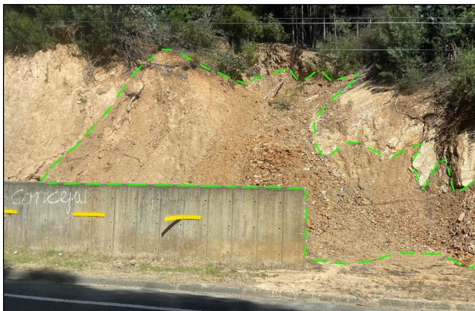
Fotografía 5.7.: Deslizamiento traslacional de suelo marcado por línea segmentada, sector San Juan de Collicura, comuna de Santa Juana. Fuente: Archivo fotográfico Grupo de Multiamenazas Biobío, 2024.
