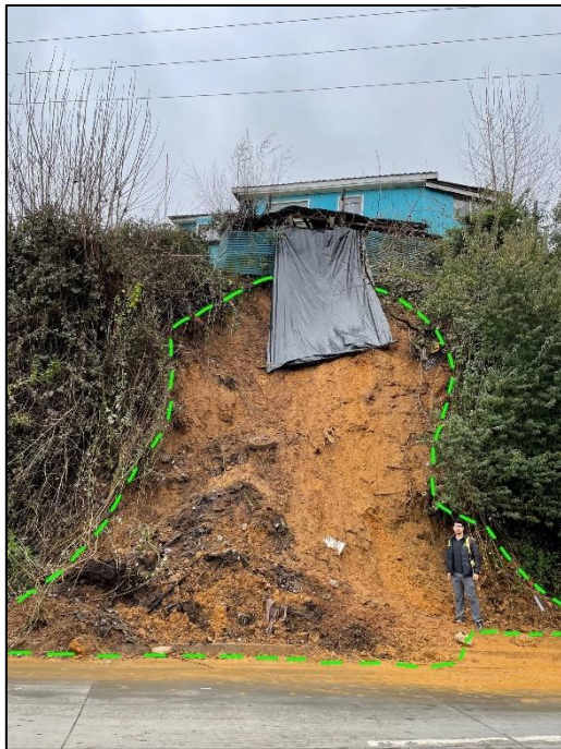
Fotografía 5.6.:Deslizamiento traslacional de suelo marcado por línea segmentada, calle Carrera, comuna de Lota. Tomada por Abisag Ortega, 2022.
