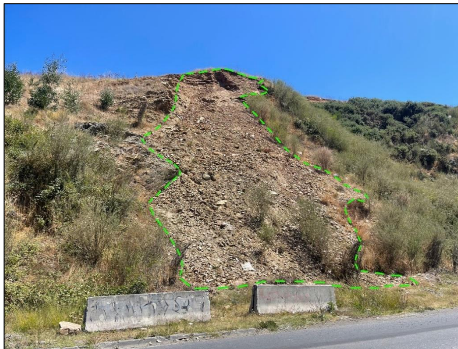
Fotografía 5.2.: Deslizamiento de suelo y rocas marcado con línea segmentada, cerro Yobilo, comuna de Coronel. Fuente: Archivo fotográfico Grupo de Multiamenazas Biobío, 2023
