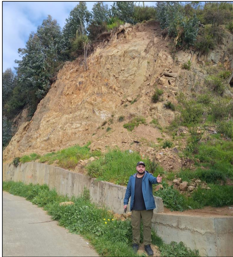
Fotografía 4.3: Deslizamiento de suelo y caída de roca en sector Diagonal Freire. Tomada por Felipe Baltierra.
