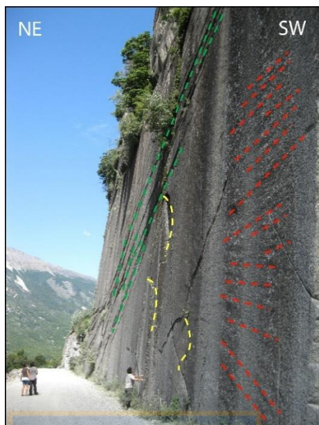
Figura 5.17. Pared truncada del río Norte. Líneas segmentadas en rojo representa estrías; líneas amarillas segmentadas indican sacados semicirculares; líneas segmentadas en verde señalan las grietas elongadas.
