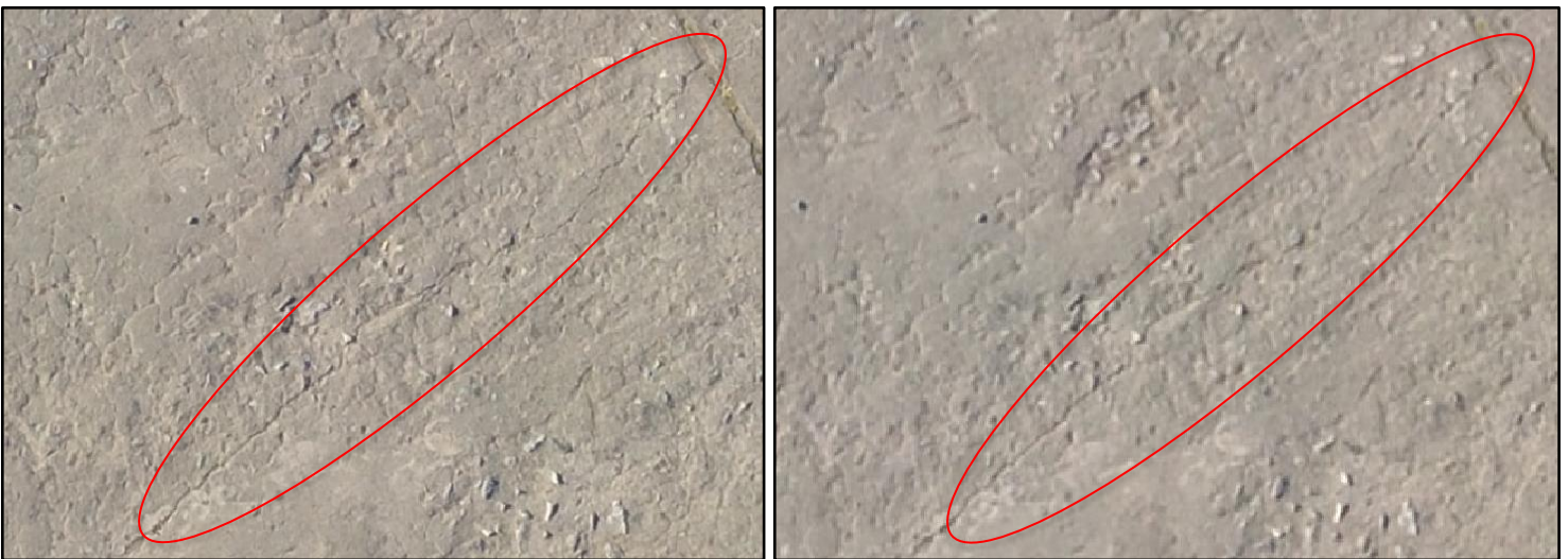
Figura 9: Observación del mismo deterioro con alturas de vuelo de 10 m y 15 m.
