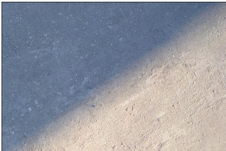
Figura 11: Impacto de la sombra en la detección de deterioros.
