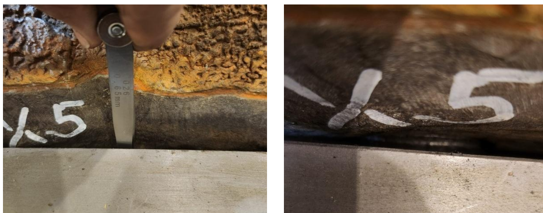
Anexo 39: Deformaciones en la unión enflanchada trunnion-tapa del shell.
