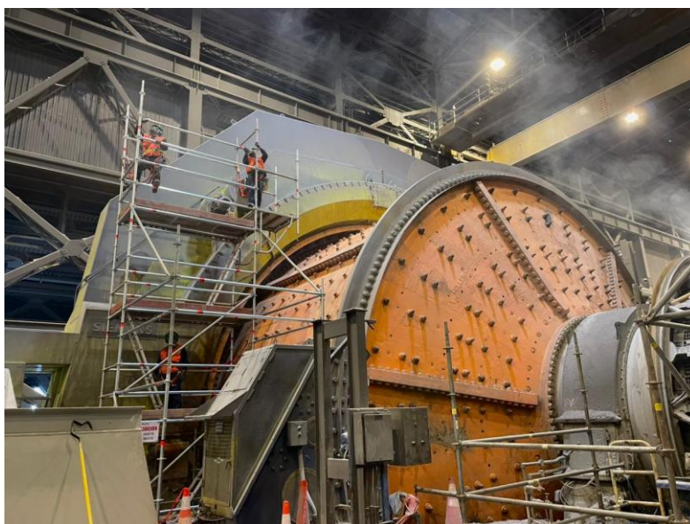
Figura 2: Molino SAG 02 de Minera los Pelambres.
