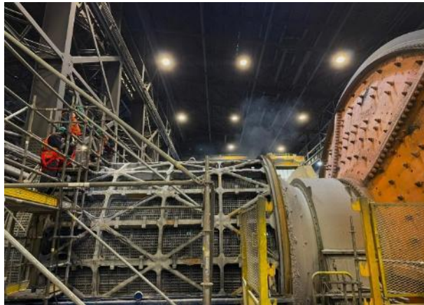
Figura 8: Componentes en la zona de descarga del molino SAG 02.
