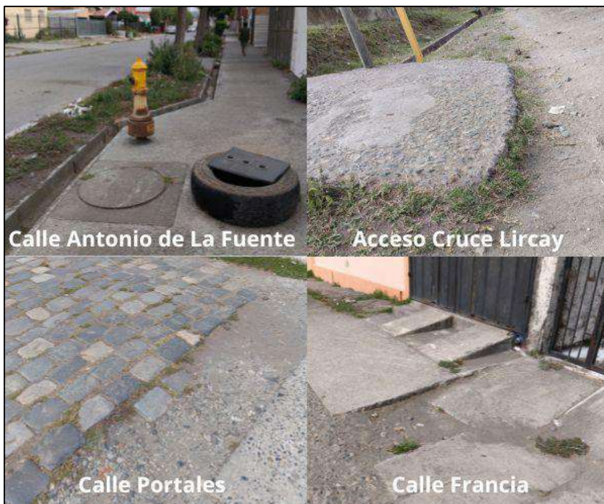
Imagen 6. Registro fotográfico de obstáculos para la movilidad peatonal de personas mayores en el Barrio Gaete.
