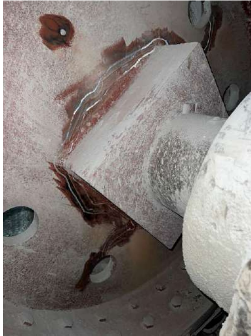
Figura 7.3: Daños en motor. Fuente: Elaboración Propia
