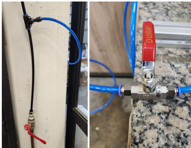
Figura 50: Conexión entre la red de aire del taller y la válvula de bola del circuito neumático.
