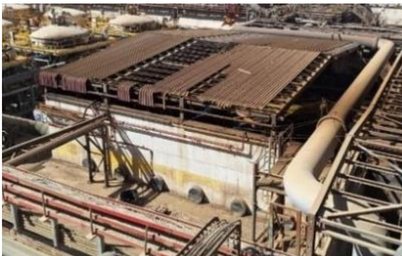
Figura 50: Estanque de almacenamiento TK-401 de orgánico cargado (Castillo, 2024)
