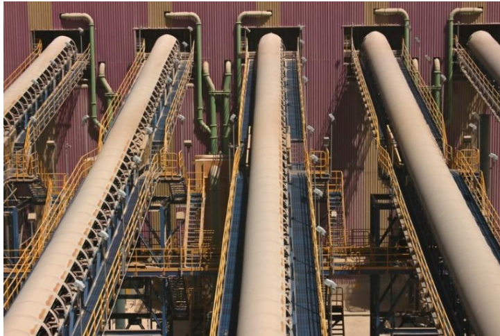
Figura 35: Líneas de alimentación a chancador secundario
