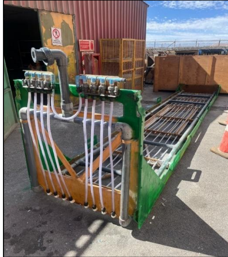
Figura 69: Mantenimiento de parrilla de aireación (Imagen propia, 2025)
