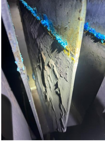
Figura 10: Corrosión anódica producto de celda des energizada (Imagen propia, 2025)
