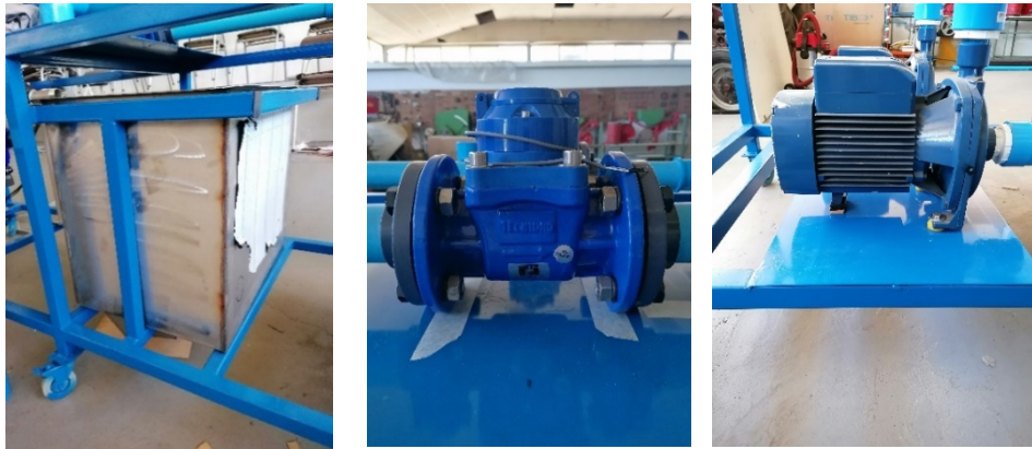
Figura 27. Estructuras de soporte instaladas en el banco de pruebas.
