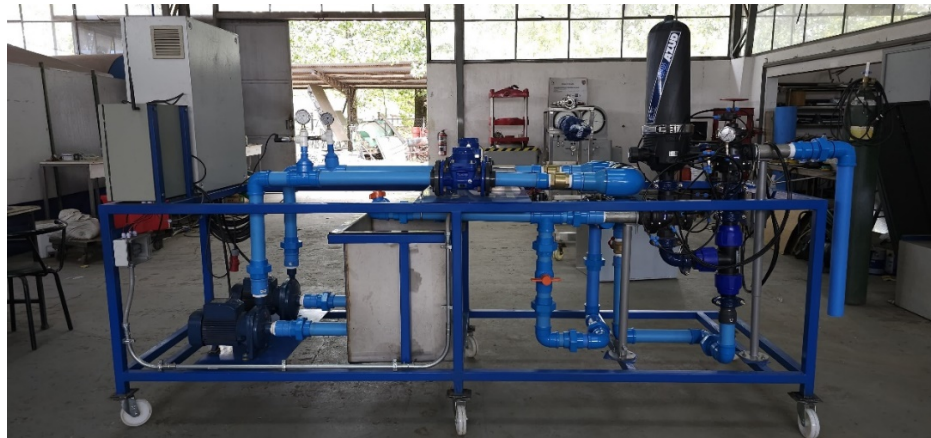
Figura 28. Vista lateral del sistema de bombeo construido.
