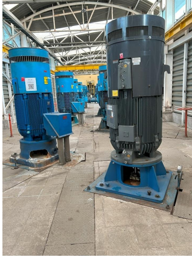
Figura A 15: Grupo de bombas Cerro Chepe
