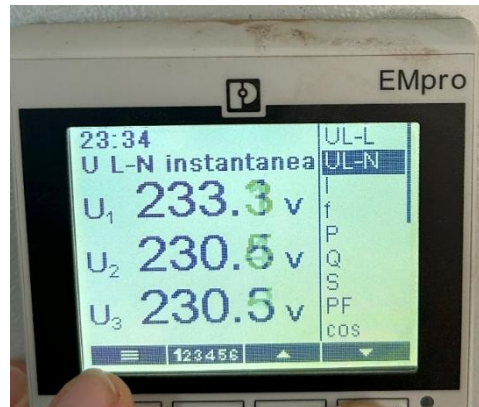
Figura A 1: Voltaje de fase Sanchina N°2 prueba sin condensador.
