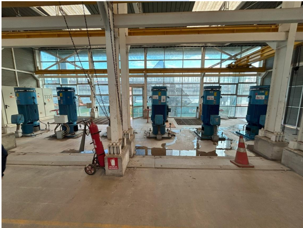
Figura A 16: Grupo de bombas captación
