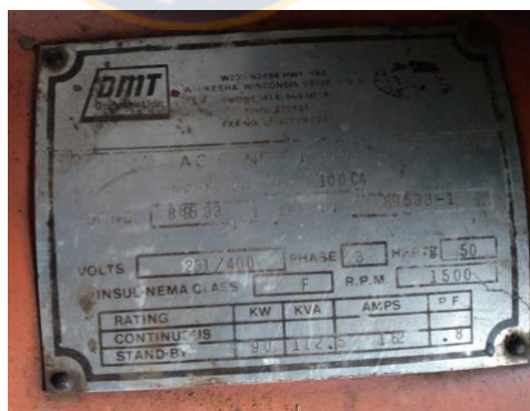
Figura 4. Placa del equipo electrógeno, que detalla características técnicas de funcionamiento. Fuente: Elaboración propia.
