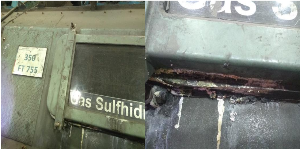
Figura 58 C. Corrosión tapa celda
