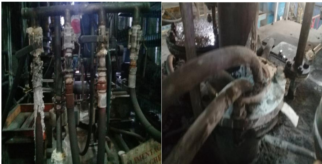
Figura 45. a) Sistema de distribución manual de NaHS al ST-17 b) Punto de adición sin flujómetro ST-17
