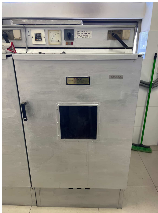
Figura A8.1: Horno a convección para termo-fijación a 170°C
