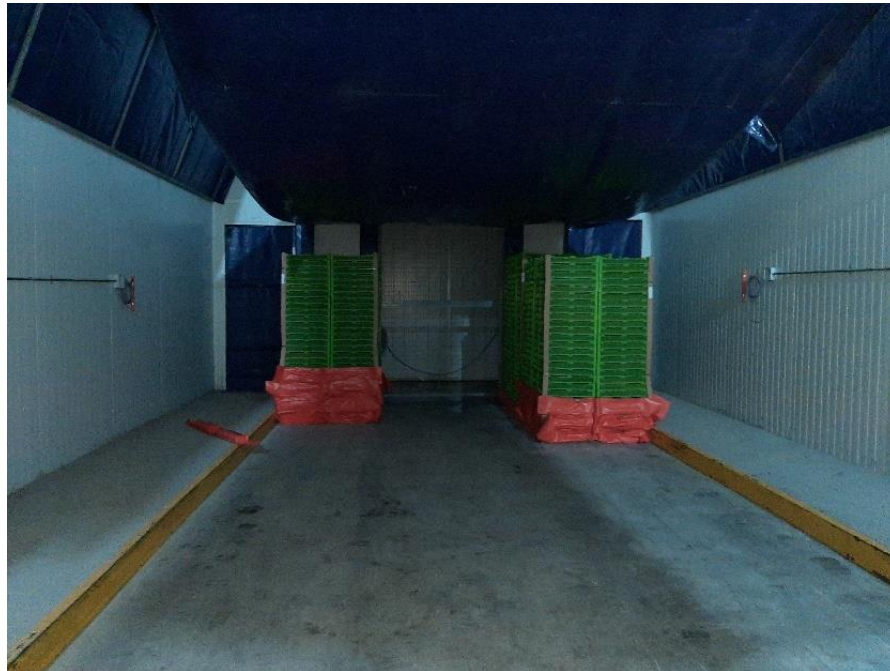
Figura 21. Cámara de pre-frío para materia prima.
