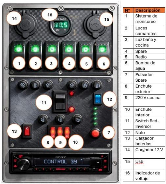
Figura 6.2 Interruptores rotulados al interior de la planta
