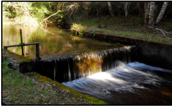
Figura 2.5 Captación sobre el estero
