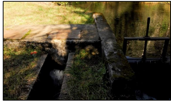
Figura 2.6 Agua permeando cámara de toma de captación
