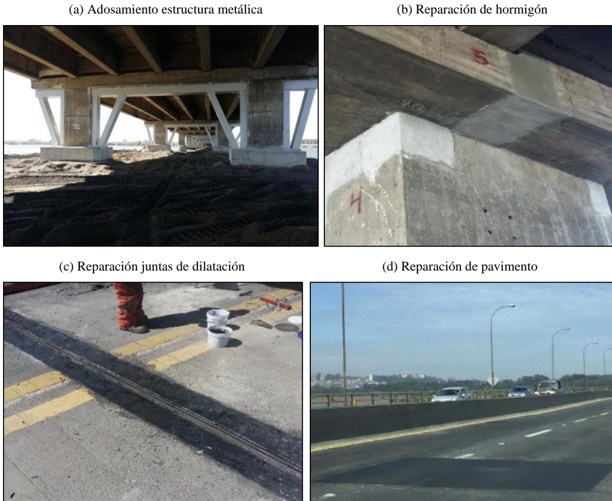
Figura 3.4. Evidencia fotográfica de la última reparación del puente.
