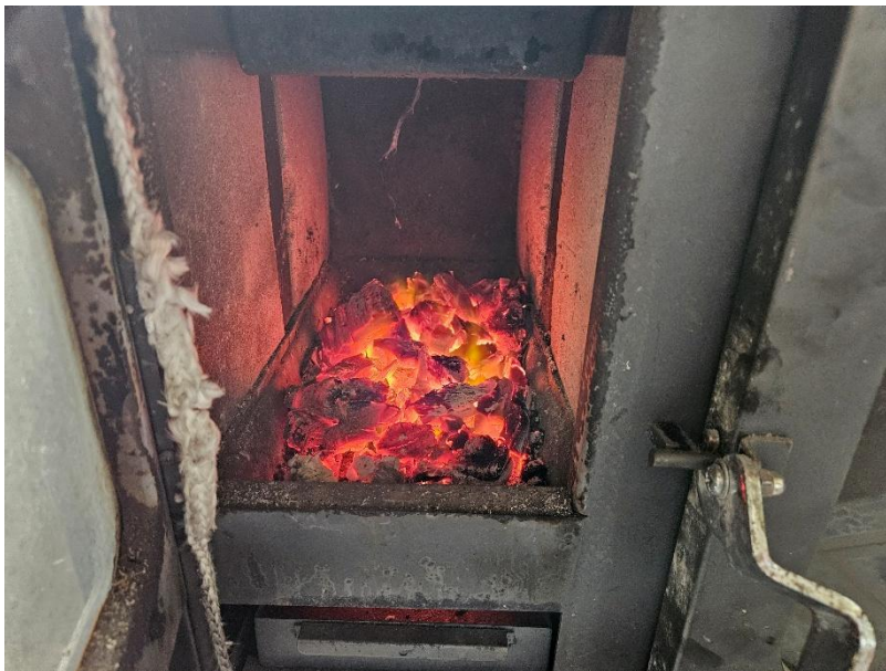
Figura 12. Estado del lecho de brasas al alcanzar el 5% de la masa residual.
