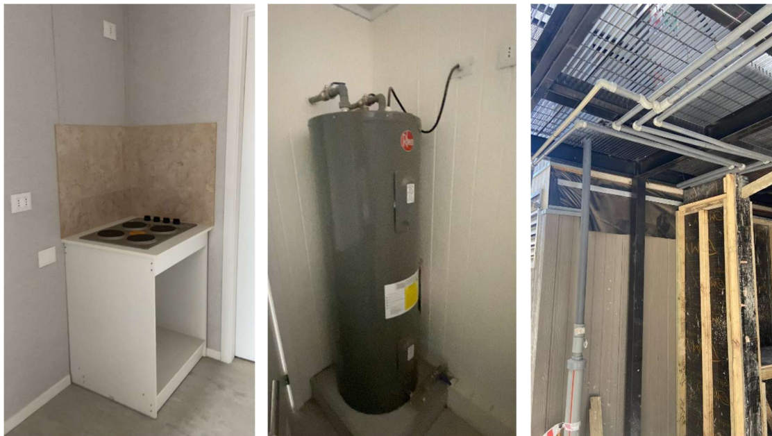
Imagen 24 - Detalle de suministros y servicios instalados en obra. Fuente: Elaboración Propia
