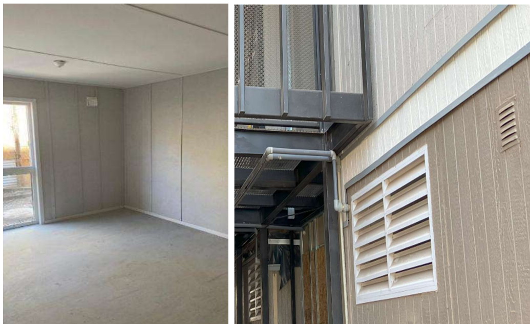
Imagen 6 - Detalle Sistema de Ventilación Pasiva según normativa PDA para la RM. Fuente: Elaboración Propia
