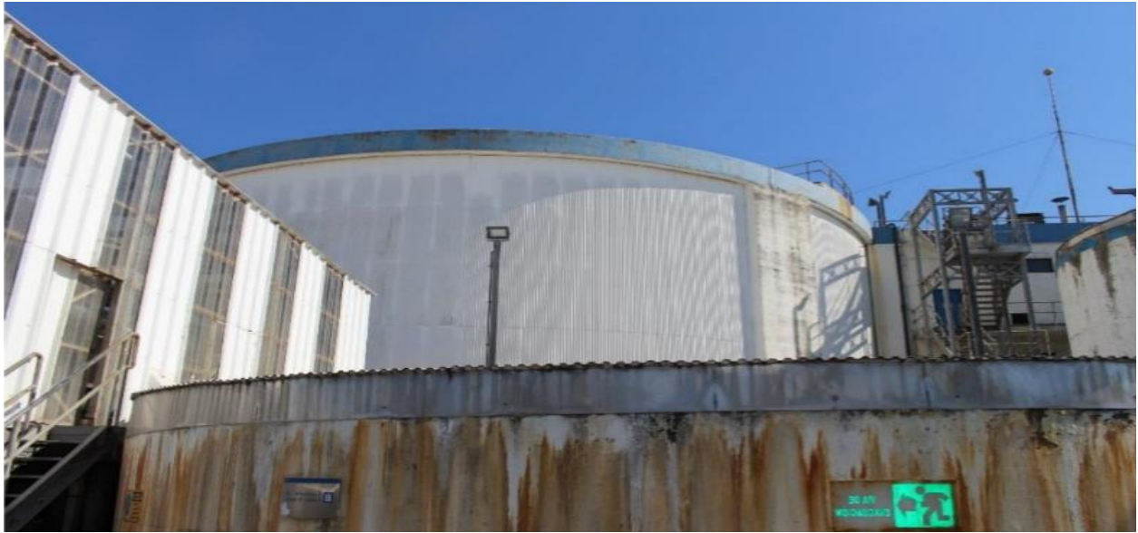
Figura 21. Digestor anaerobio para tratamiento de lodos.
