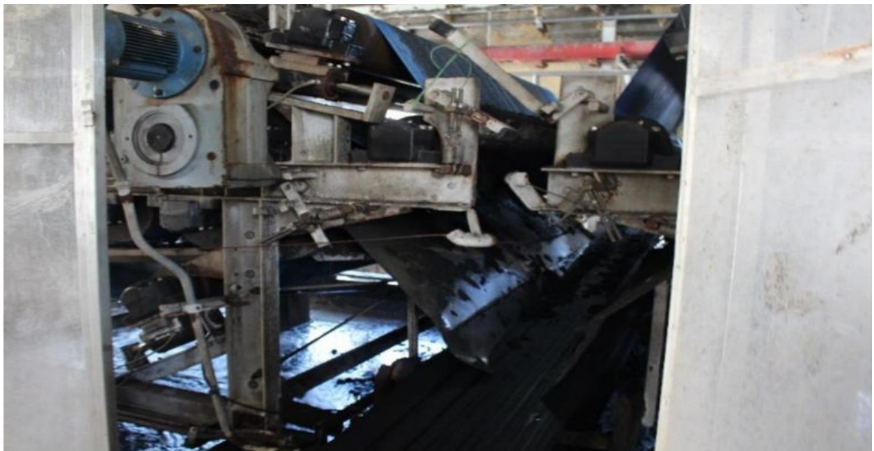
Figura 22. Prensa de banda para deshidratación de lodos digeridos
