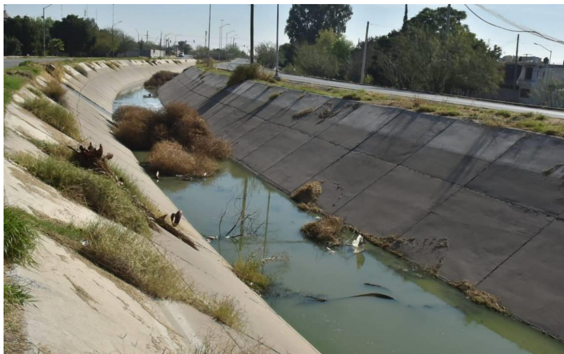
Figura 4. Problema por vegetación en un canal de riego de hormigón armado.
