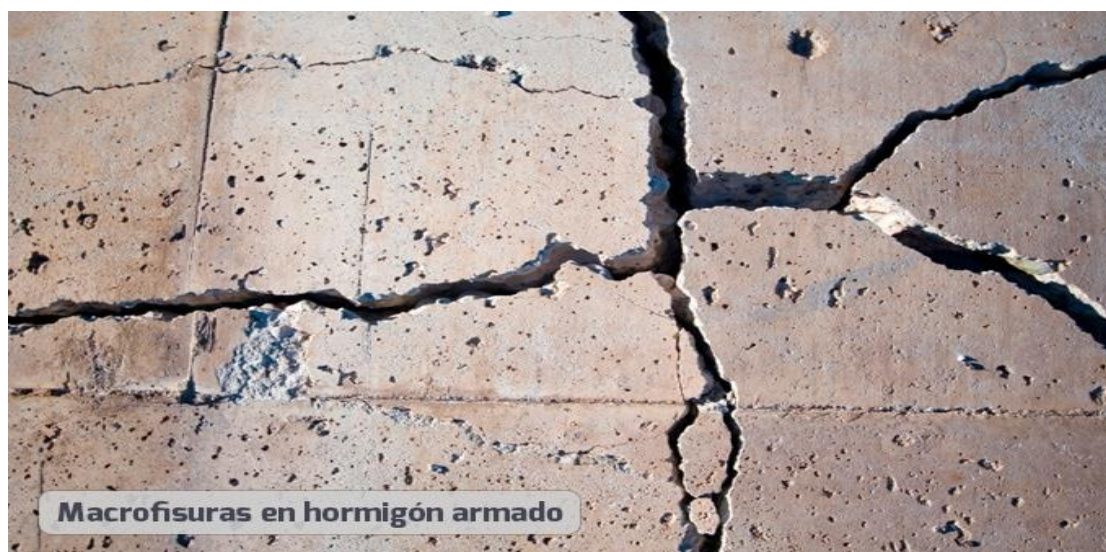
Figura 5. Microfisuras en hormigón armado. Fuente:
