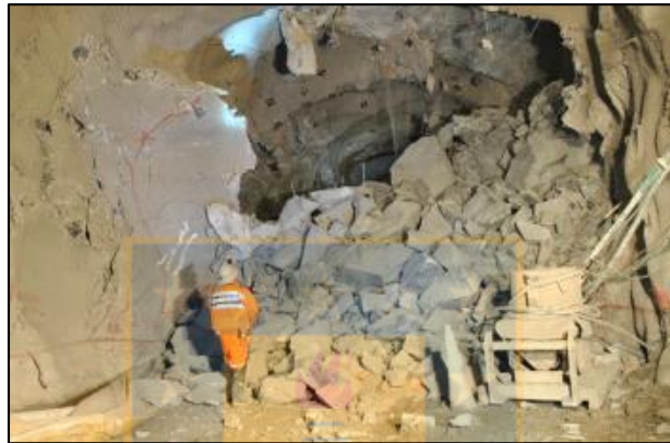
Figura 3.8: Estallido de roca en Xc 22/23 PNNM, 19 de mayo 2015. (Validación de la Constructibilidad PNNM, 2017)
