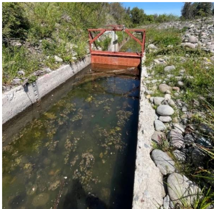
Figura 2. Compuerta del canal matriz Retiro. Fuente elaboración propia.
