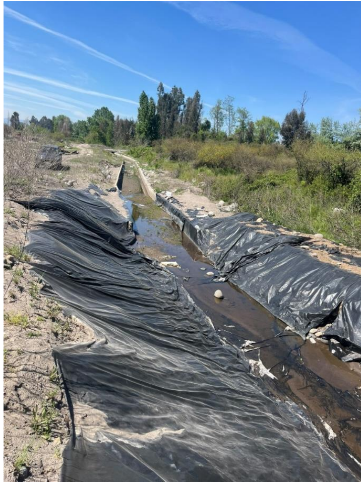
Figura 4. Situación actual del canal retiro en las coordenadas UTM 259091.m E, 6000500. m S (datum WGS 84). Fuente elaboración propia.
