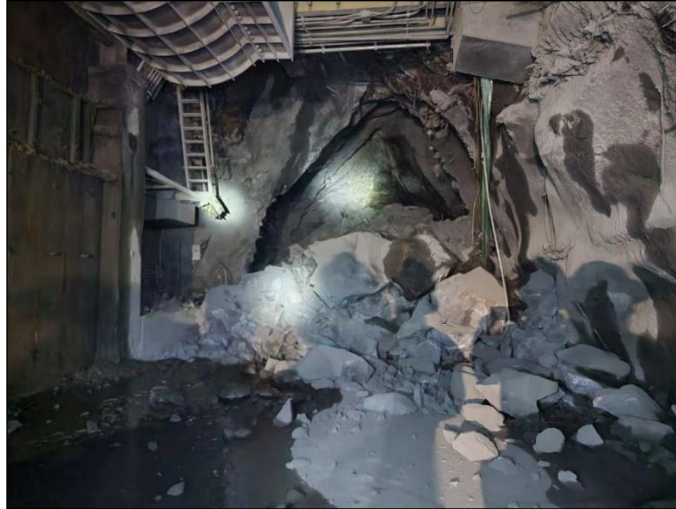
Figura 2. 4: Daños estructurales en labores del Proyecto Andesita tras evento sísmico el 24 de julio de 2023 [6].
