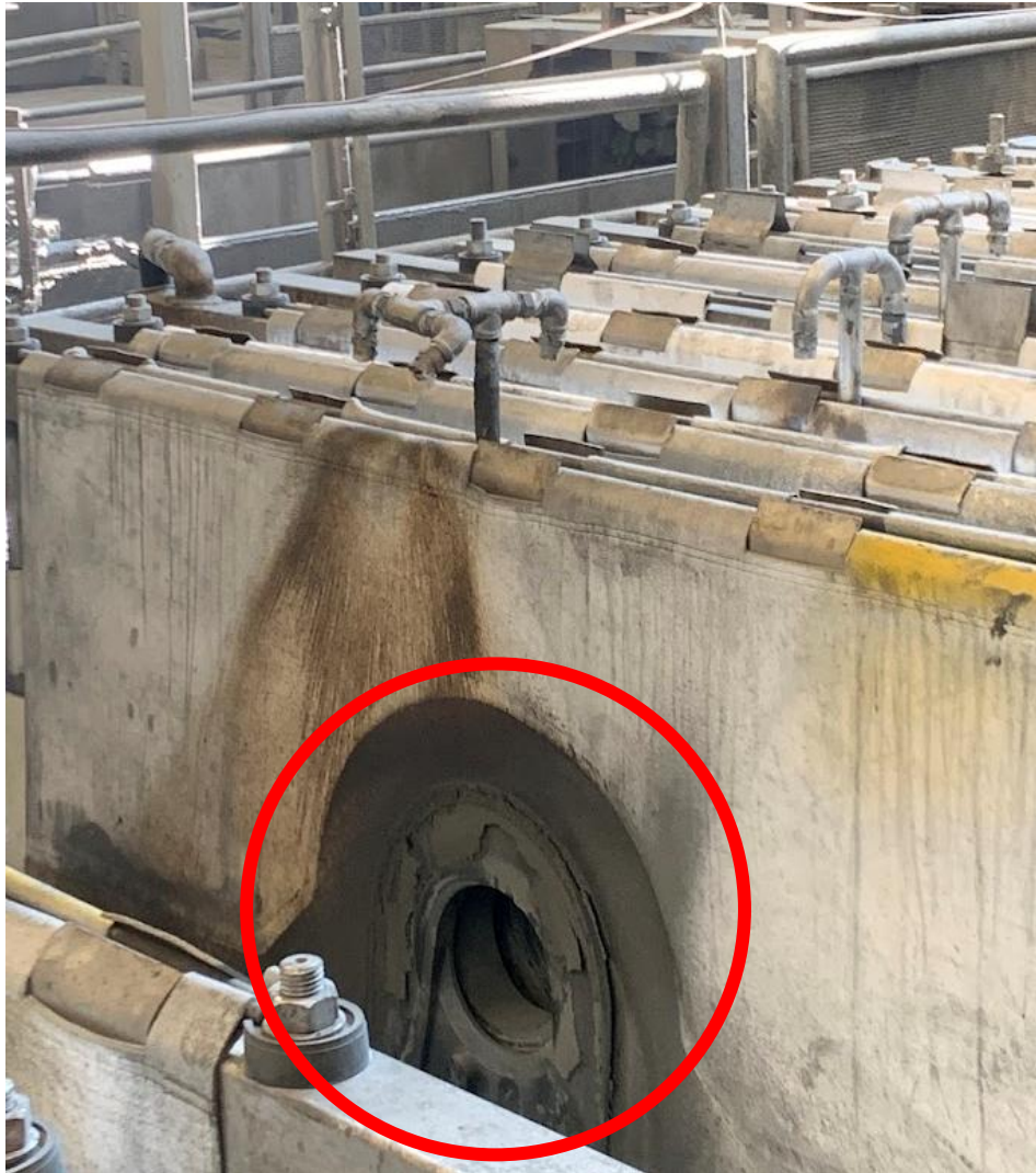
Anexo 9: Restos de Concentrado en Tela debido a Lavado Insuficiente.
