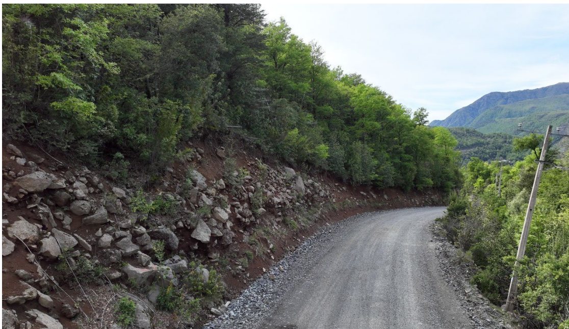
Figura 9. Contexto geomorfológico de una remoción en masa validada en terreno: Taludes de depósitos mal seleccionados en la ruta Q-689
