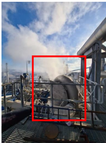
Figura 20. Vista superior Estanque de Licor Concentrado de tubería de alivio de gases conectado a la línea de extracción DNCG, con presencia de vahos el día 26 de enero de 2023.
