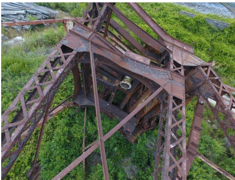
Fotografía N°5 Cabría destruida e irreparable de Pique Alberto Sector Chambeque. Fuente: Elaboración Propia, 2023.
